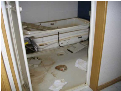
(浴槽：破損している。)
