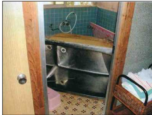
(浴槽：転倒し、配管が切れている。)
