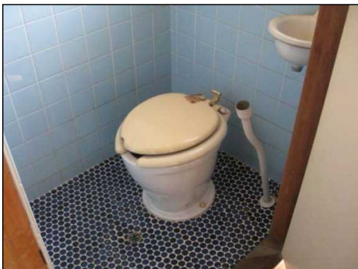
(便器・洗面：配管が外れている。)
