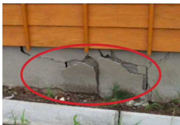
基礎の破壊(内閣府災害に係る住家の被害認定基準運用指針 参考資料より)
